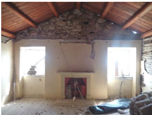
Φωτ. 8 βλάβες στη θέση του τζακιού, έδραση στέγης επί αετώματος
