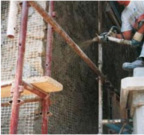
Φωτ. 17 οπλισμένο επίχρισμα
