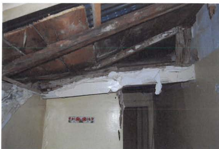
Αστοχία φέροντος οργανισμού στέγης
