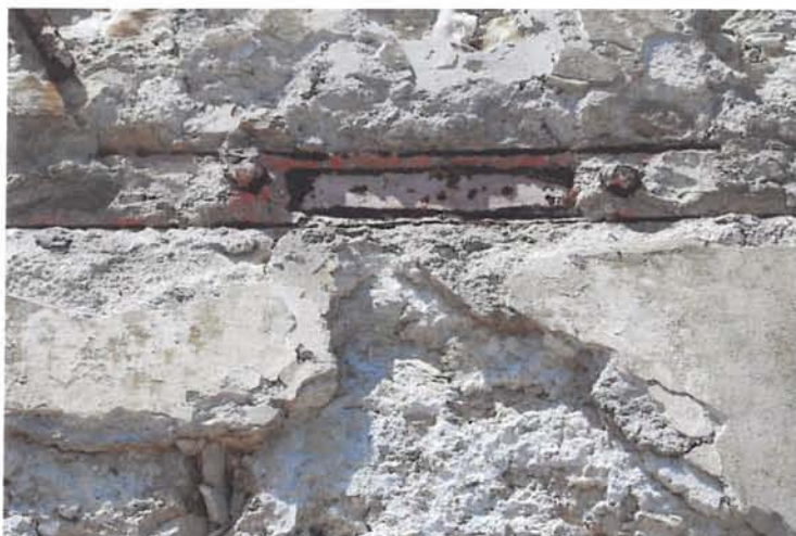
Οξείδωση μεταλλικών εντατήρων
