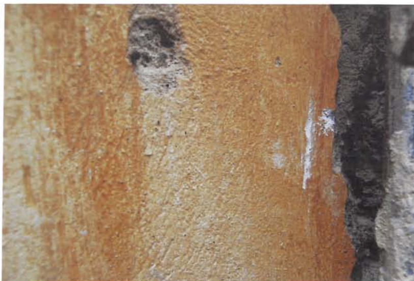
Χρωματισμοί στην όψη επί της οδού Σερεμέτη
