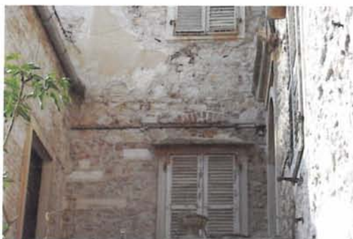
ΟΞΕΙΔΩΜΕΝΟΣ ΕΝΤΑΤΗΡΑΣ ΣΤΟ ΧΩΡΟ ΕΙΣΟΔΟΥ ΣΤΟΝ Α' ΟΡΟΦΟ
