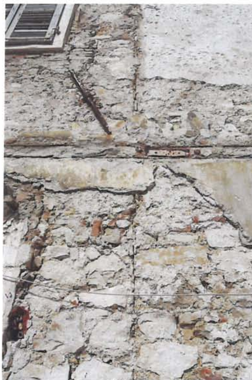
Κατακόρυφη ρωγμή (αρμός)
