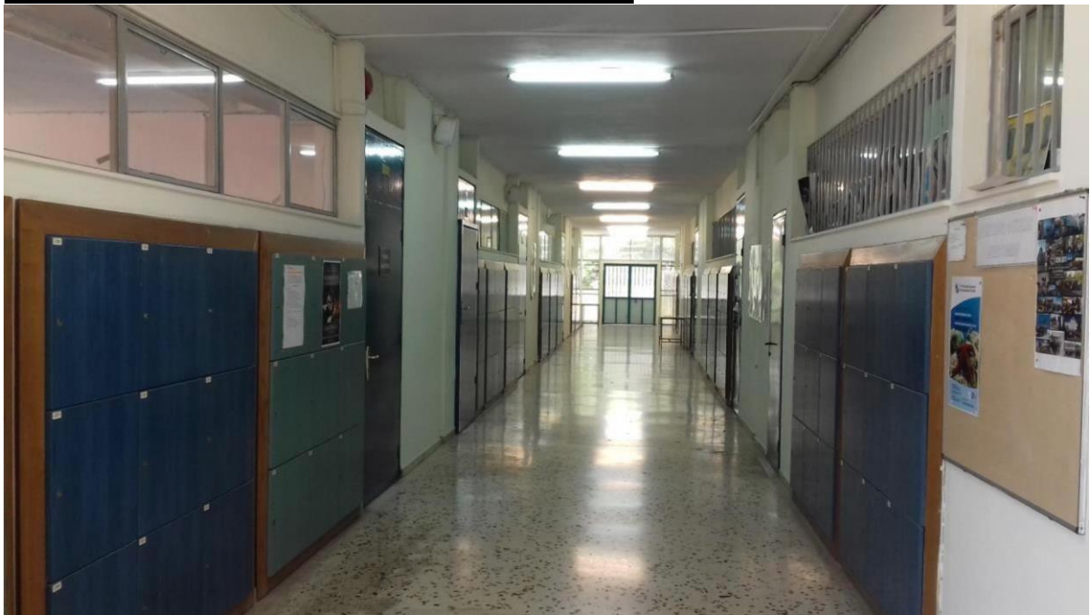
ΔΙΑΔΡΟΜΟΣ ΜΩΣΑΪΚΟ ΚΑΙ ΦΩΤΙΣΜΟ ΛΑΜΠΕΣ ΦΘΟΡΙΟΥ
