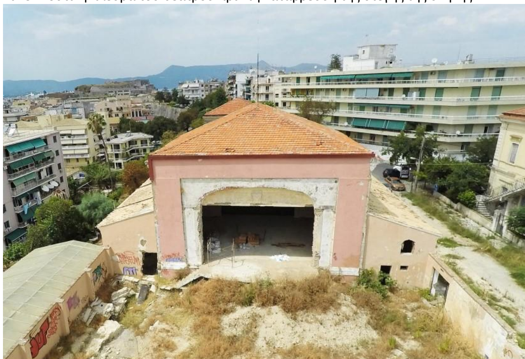
Εικ.4 Άποψη της σκηνής από την πλευρά του θερινού θεάτρου (νότια πλευρά) πριν τη κατάρρευση της στέγης της σκηνής
