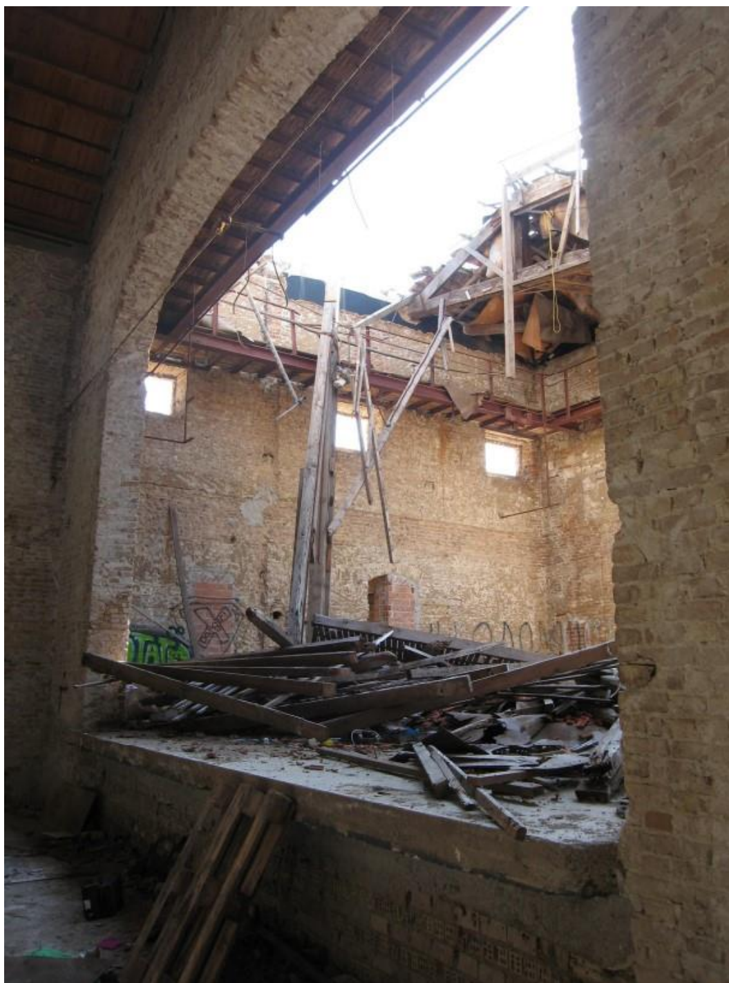
Εικ.8 Άποψη της σκηνής στο εσωτερικό του χειμερινού θεάτρου μετά την κατάρρευση της στέγης της σκηνής
