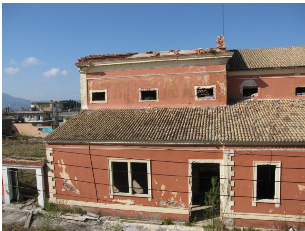
Εικ. 6 Άποψη της ανατολικής πλευράς του θεάτρου μετά την κατάρρευση της στέγης της σκηνής
