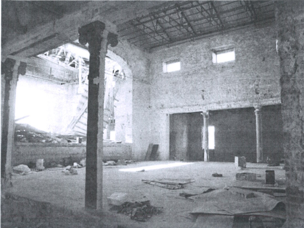
Άποψη της πλατείας του χειμερινού θεάτρου. Διακρίνεται τμήμα του τοίχου της σκηνής και της στέγης που έχει καταρρεύσει.
