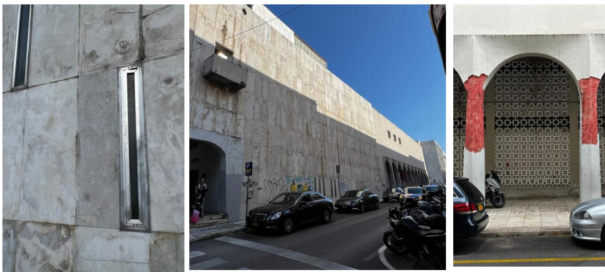
51, 52. Ορθομαρμαρώσεις πρόσοψης και πλάγιων όψεων χρήζουν επισκευής, 53. Φθορά (αποκόλληση του επιχρίσματος και αποκάλυψη του διαβρωμένου οπλισμού) στα μπετονένια τόξα κατά μήκος της οδού Ν. Μαντζάρου
